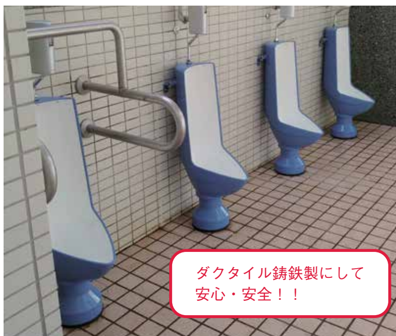
設置場所：駒沢オリンピック公園 2号トイレ
