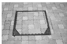
①設置状態
