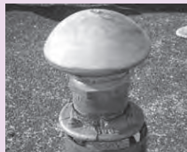
①劣化した防水継手
