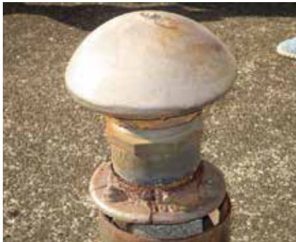
①劣化した防水継手
