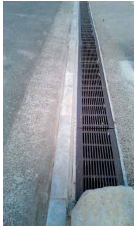
東京都 武蔵野市 境山野公園側溝蓋
