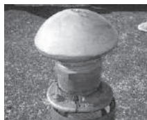
①劣化した防水継手
